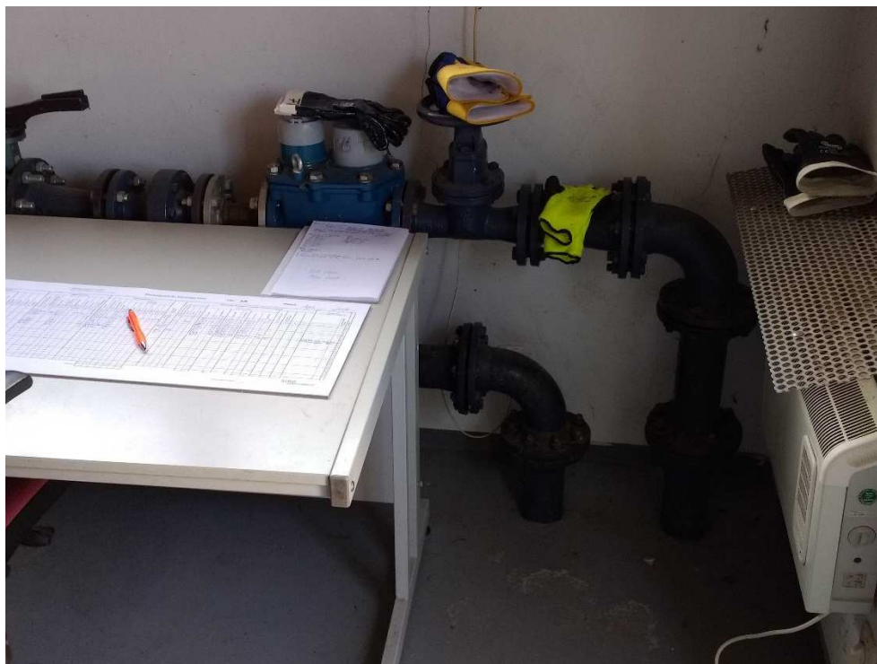
Wasseranschluss im Wärterraum
