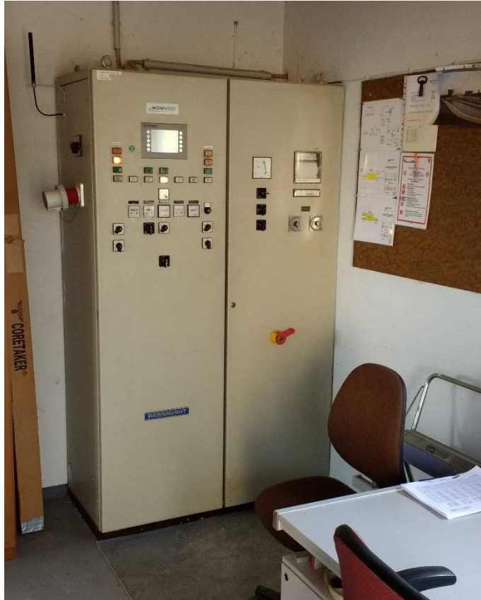
Schaltschrank im Wärterraum
