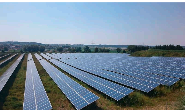
Freiflächen-Photovoltaikanlagen: Wichtiger Part in der Energiewende
