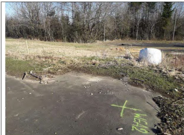
Foto 1: Ausflockung Sanierungsbereich, Blickrichtung SO
