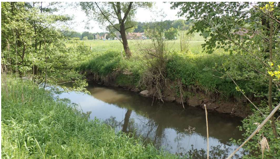
Bild 15 (Seg. 70) und 16 (Seg. 71): Das Profil ist deutlich zu stark eingetieft, so dass die Wurzelstöcke bei Niedrigwasser kaum noch Kontakt mit der fließenden Welle haben (= fehlende Unterstände).
