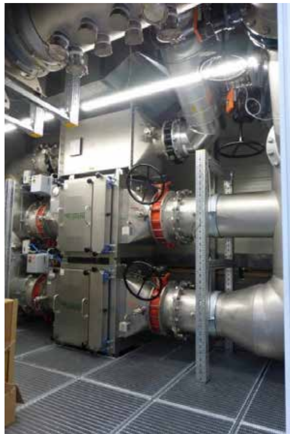
Blick in die Lüftungszentrale
