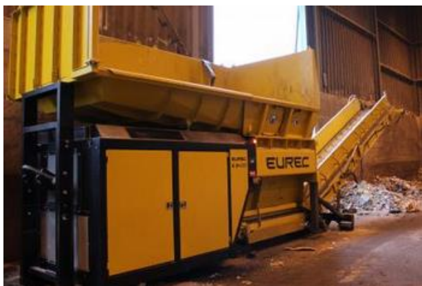
Abb.: Zerkleinerer für Sperrabfälle in der Umschlagshalle
